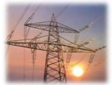
Figura 357 Traliccio in alta tensione
